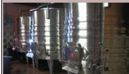
Les nouvelles cuves aluminium faites sur mesure pour la cave du domaine
